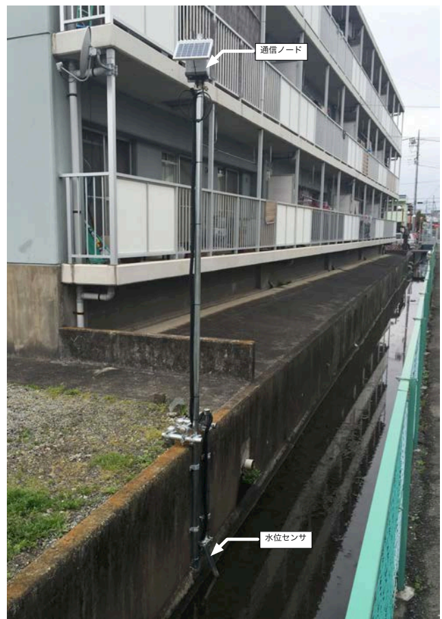
図 3: 河川支線に設置された水位計測システム
