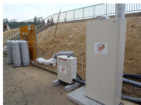
d. ガスエンジン コジェネレーション (本田技研工業株式会社提供)
